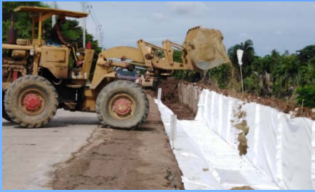
ดำเนินการปูแผ่นใยสังเคราะห์ และลงทรายถมคันทาง
